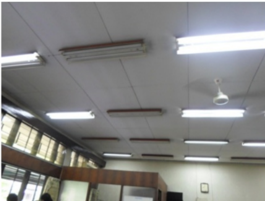
Foto 34. Sebagian penerangan yang tidak berfungsi
