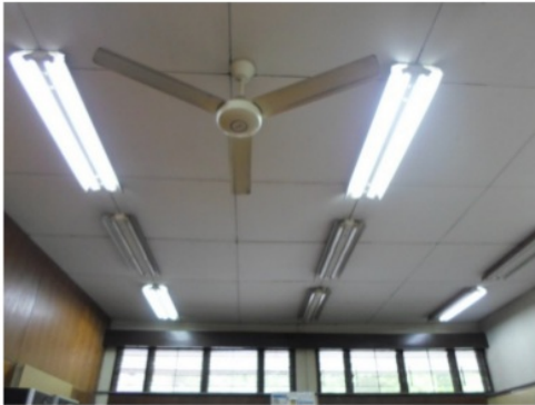
Foto 26. Sebagian penerangan tidak berfungsi
