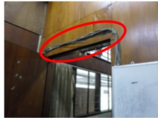
Foto 18. Foto Instalasi kabel tanpa penutup
