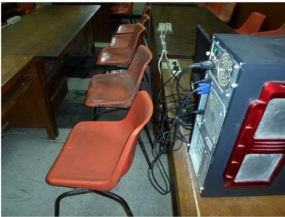
Foto 31. Instalasi kabel yang tidak rapi
