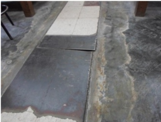
Foto 33 lantai Laboratorium yang rusak
