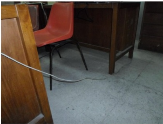
Foto 28. Instalasi Kabel yang tidak rapi
